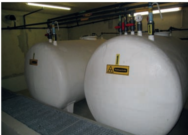
Cuves de gestion en décroissance des effluents contaminés produits par le service de médecine nucléaire du centre hospitalier de Beauvais
