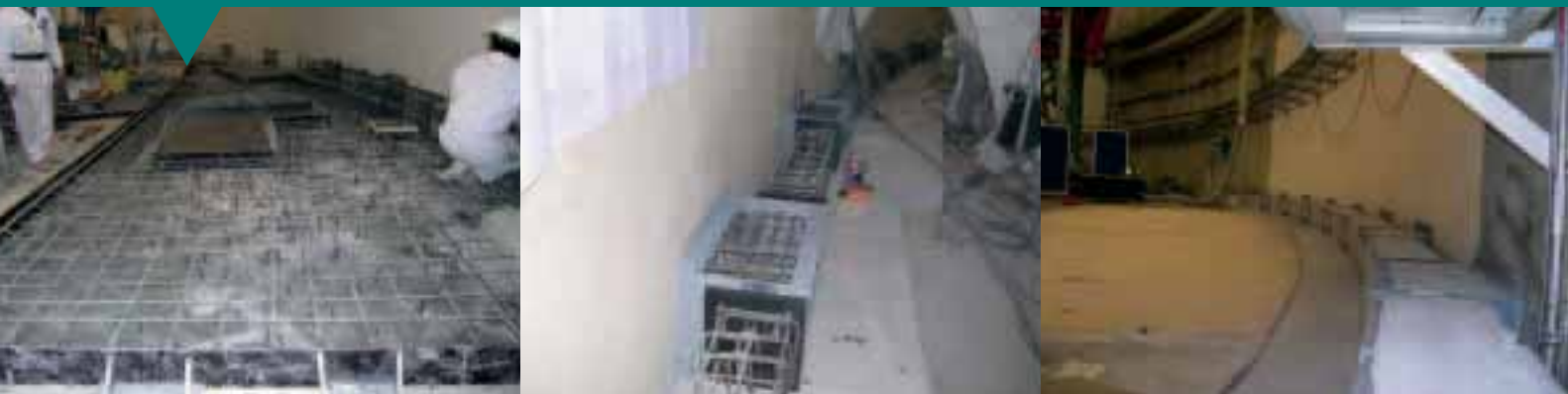
Renforcement de la liaison entre le plancher du hall piscine et l'enceinte du réacteur
