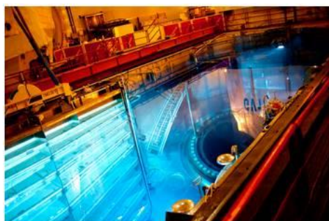
Figure n°5 : piscine de refroidissement
