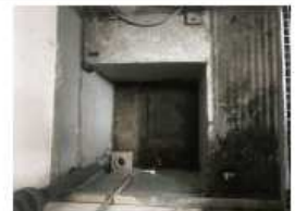
2 ème point de contrôle de débordement des cuves si rien au 1 er
