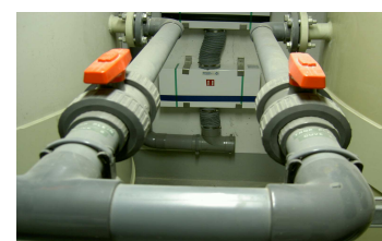
Vanne trop-plein ouverte.
