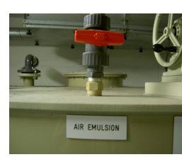
« air comprimé » fermée
