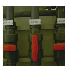
« Rejet cuve 2 » ouverte
