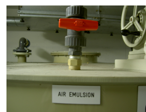
Vanne « air comprimé » fermée
