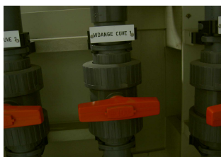
« Vidange cuve 1 » Fermée
