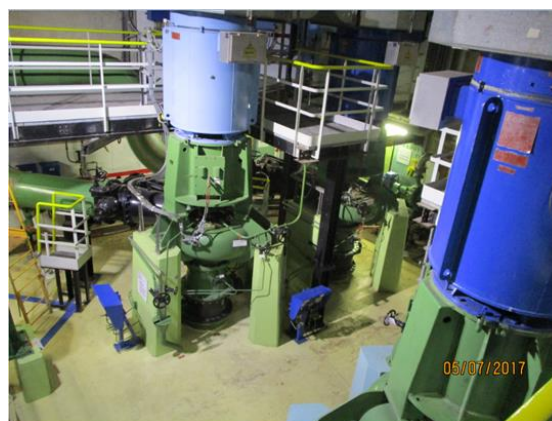
Salle des pompes du circuit d'eau brute secourue
