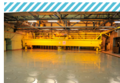
Hall d'entreposage de déchets vitrifiés de haute activité - établissement de La Hague
