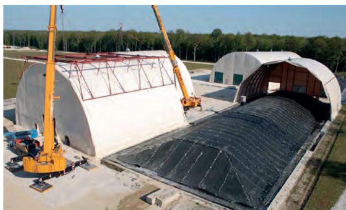
Opérations de fermeture d'alvéoles et de déplacement de la toiture mobile sur le site de Morvilliers (Aube)
