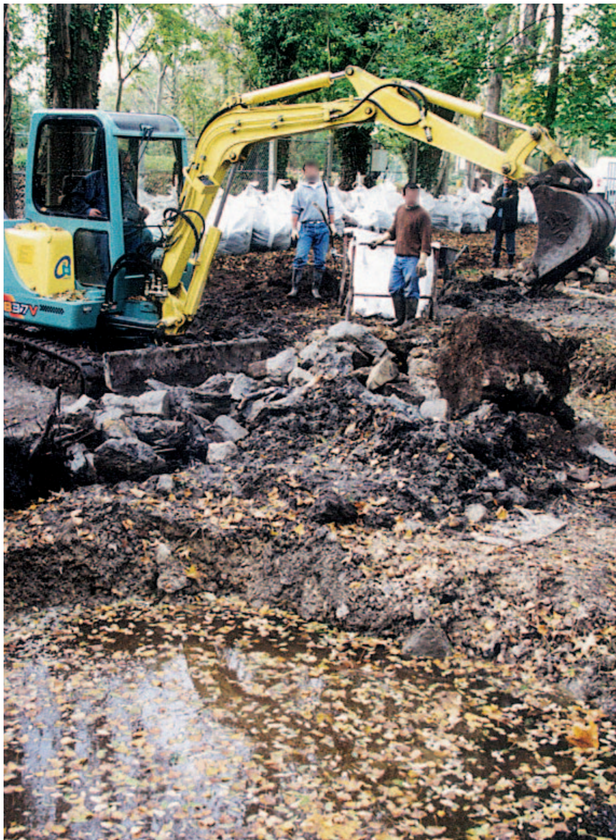
Réhabilitation du terrain CEA de l'Île Verte (Essonne). Vue pendant les travaux.
