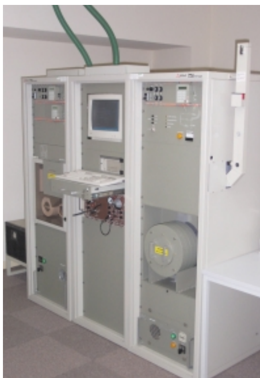
Mesure des poussières de l'air
